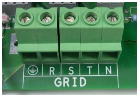
Abb. 11 Klemmenbrett für den Anschluss der AC-Kabel
